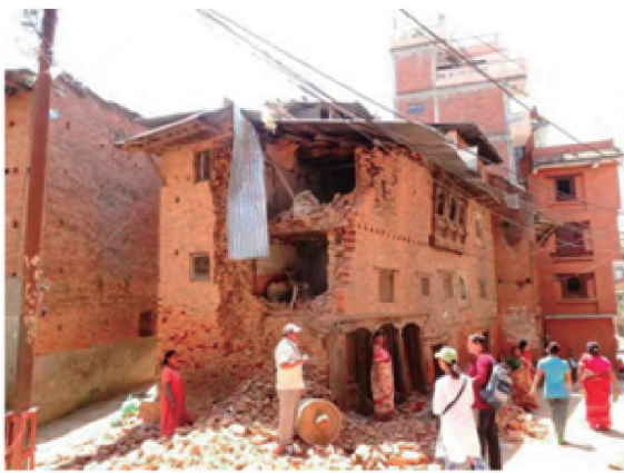
图1. 2015年廓尔喀地震中损坏的未加固砌体结构建筑[3]。
