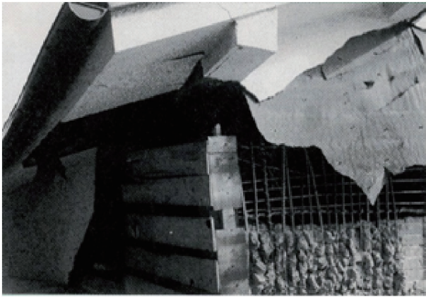
图8. 1995年阪神大地震中一座木屋的连接处断裂[8]。
