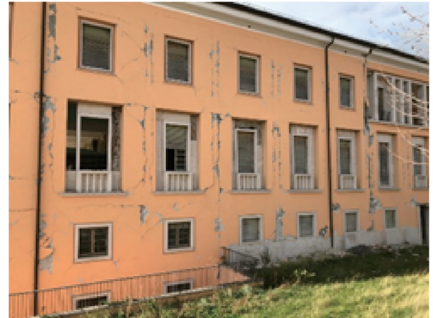
图12. 在2016年阿玛特里切地震后没有倒塌但再未被使用的受损建筑物。
