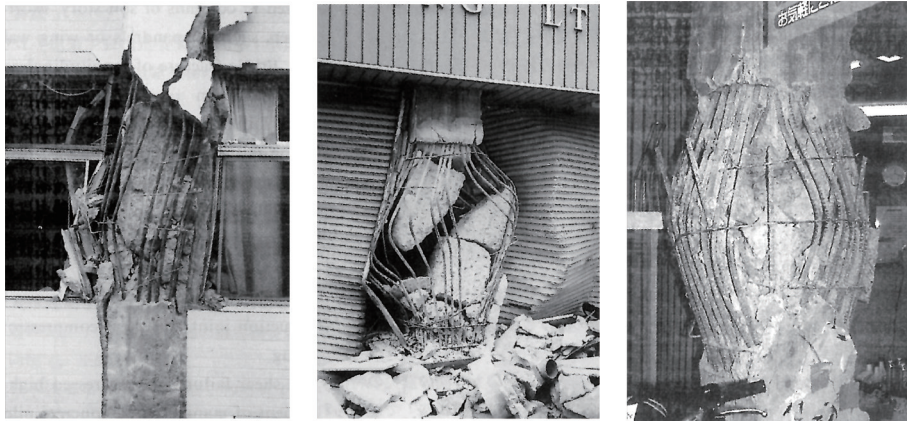
图6. 1995年阪神大地震中RC柱的损坏[6]。
