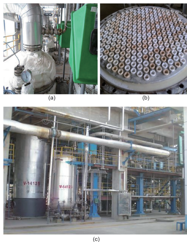
图12. 多孔CMR的工业应用。(a) 环己酮氨氧化膜反应成套设备；(b) 241芯膜组件；(c) 对氨基苯酚反应器成套设备。
