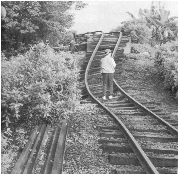
图 3 南投县铁路轨道因断层通过发生隆起而扭曲变形
