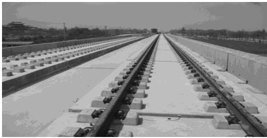
图4 郑西客运专线无砟轨道实景图
