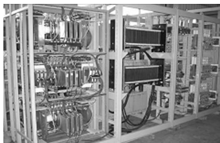
图 5 国产第一套 7.5 MVA IGCT 交直交变频器
