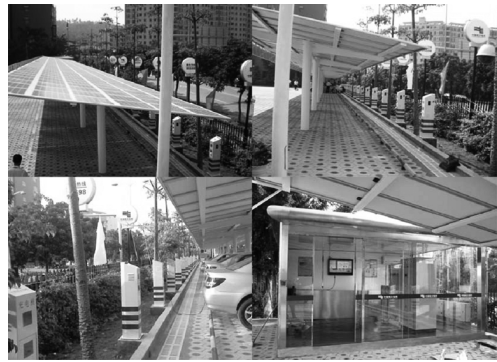
图 10 太阳能光伏建筑一体化充电停车棚实际照片
