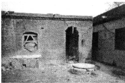
b. 采前未加固的房屋
