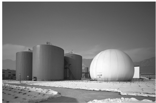
图7 北京德青源2 MW沼气发电厂(日产沼气20000 m 3 )
