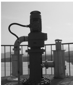
图 3 厌氧罐中心搅拌机
