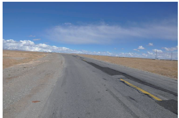
图 6 保温板路基局部坑槽
