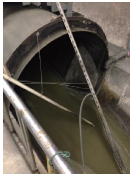
图2. 丰桥1连接点处的污水管道和污水。
