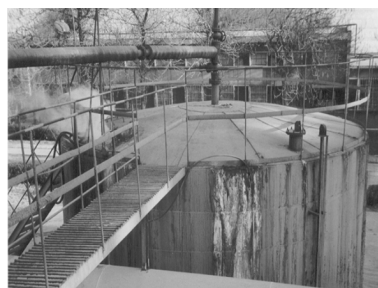
图 4 泄漏的氨水罐
