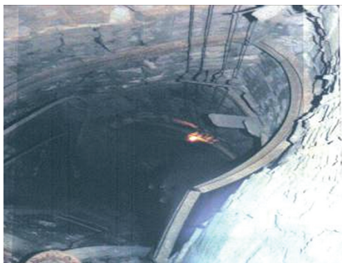
图1 三矿区深部巷道侧墙内挤破坏情况
