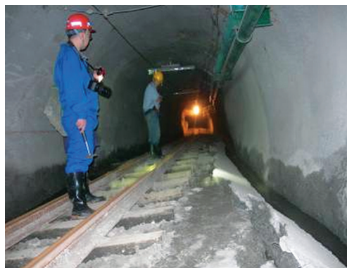
图3 龙首矿有轨运输巷道底鼓变形情况
