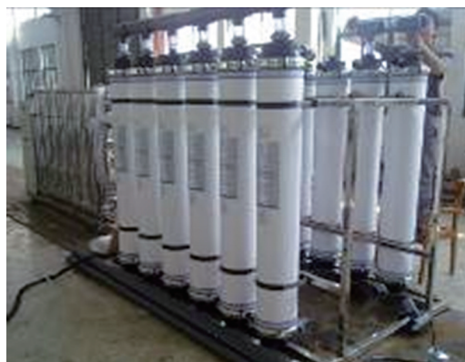
(a) 钱塘江水源自来水超滤预处理系统
