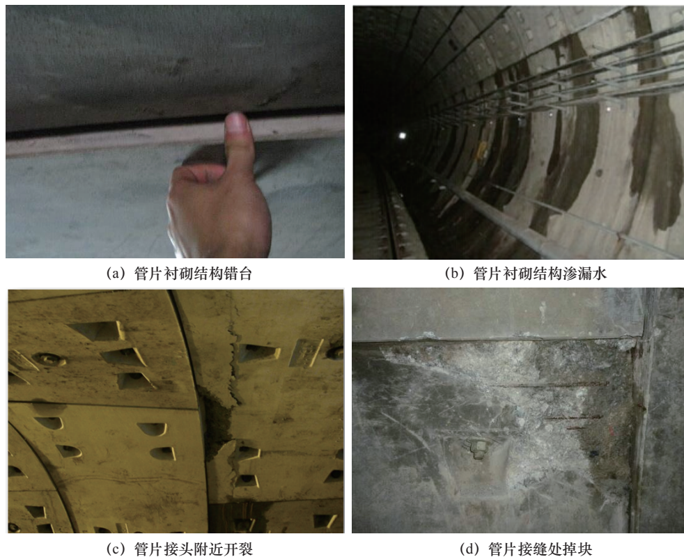
图 3 设计和施工不合理等原因导致的结构劣损
