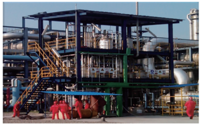
图 5. 四川省普光天然气净化厂磷石膏矿化 CO 2 中试示范装置。
