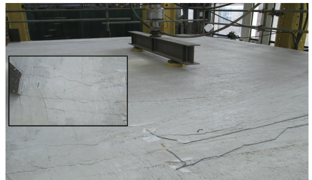
图15. 混凝土板表面沿中心主梁的裂痕。
