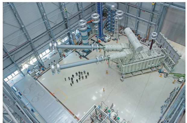
图2. 图为新建的1100 kV输电线路的两台巨型变压器之一，该输电线路在中国新疆和安徽之间延伸3293 km。变压器位于运输线路的终点，长37.5 m、重816 t。变压器的效率高于99%，可将超高压线路的直流电转换成交流电，并分配给城市。图片来源：Siemens（新闻稿）。
