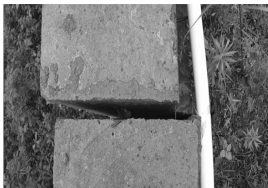
图 1 边坡挡墙开裂状况
