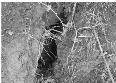
图 2 坡面开裂状况
