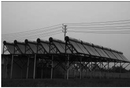
图3 太阳能热水器 Fig.3 The solar water heater
