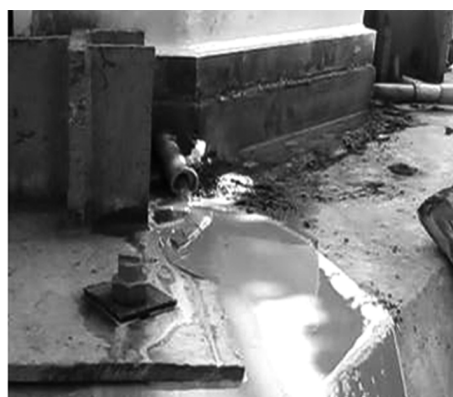
图8 排水管浓浆流出
