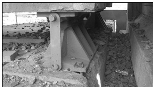
图 1 桥梁支座固定螺栓被拔出
